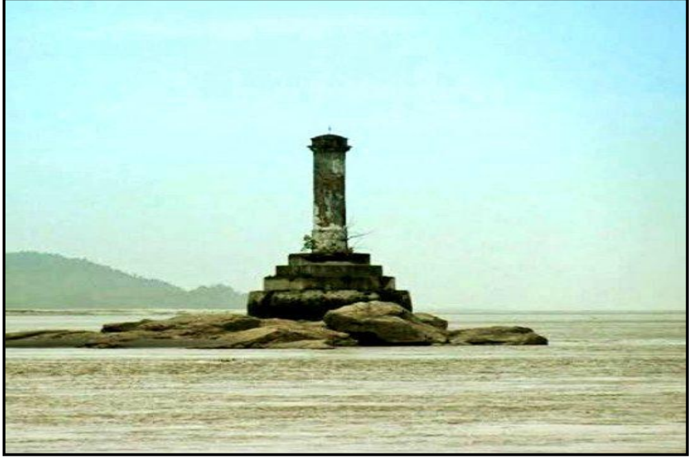
चित्र 5: स्मारक पर स्तंभ जीर्णशीर्ण अवस्था में Plate 5: The pillar on the monument in a deteriorated condition
